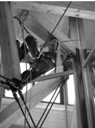
Mit Seilen gesichert führt Dominik Mäckel in der Höhe des Gemeindesaals Wartungsarbeiten aus.
